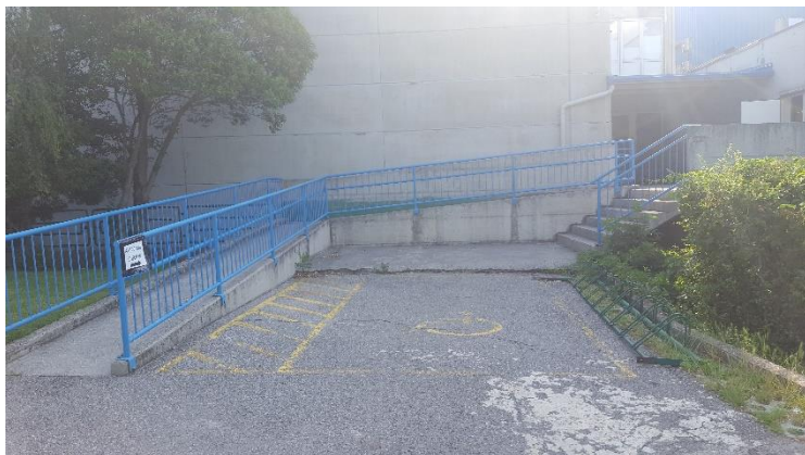
Slika A: Neustrezno urejeno parkirišče za invalide pri Zavodu za šport. Umakniti je potrebno kolesarska stojala, tudi tista ob klančini. Do parkirišča je potrebno zagotoviti dostop (dostop preprečuje zapornica) in zagotoviti tudi vertikalno oznako parkirišča (prometni znak, ki označuje invalidski prostor v skladu s standardom SIST ISO 21542).
